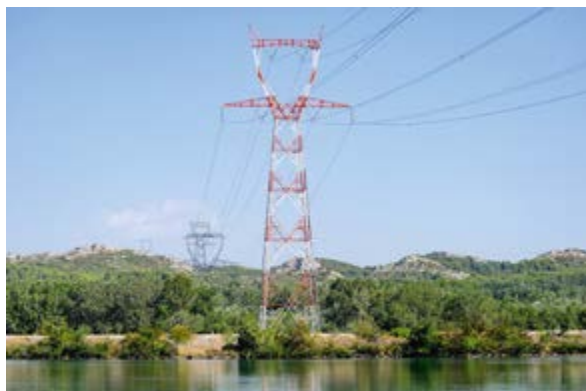
Figure C 38 : Réseau électrique aérien traversant le Rhône.
