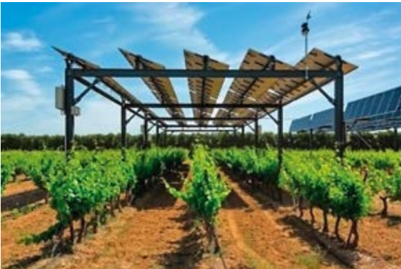
Figure C 31 : Le démonstrateur agrivoltaïque de Piolenc (84) permet d'évaluer ce type d'installation en viticulture.
